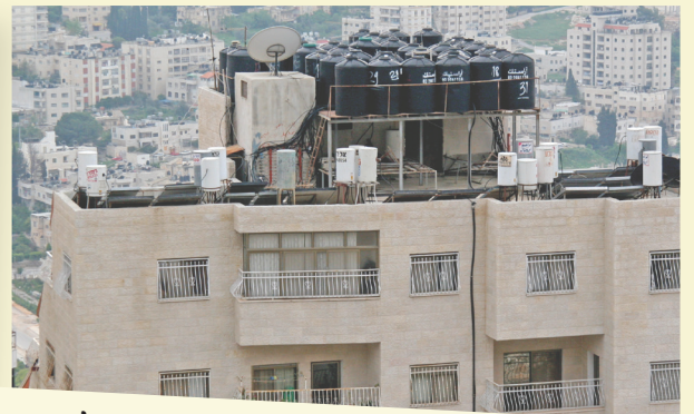
Citernes d'eau sur les toits des édifices
